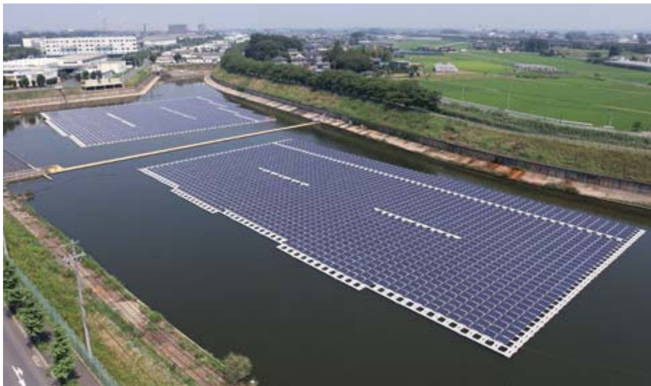
桶川市に設置されたCiel & Terreの水上設置型システムは、水による冷却効果が得られる設計により、他のPVシステムよりも発電量が10%も多いのだという。
